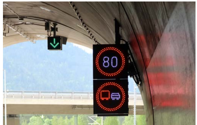
Steckverbindungen der Dauerlichtzeichen ermöglichen im Fall der Fälle einen schnellen Gerätetausch.
